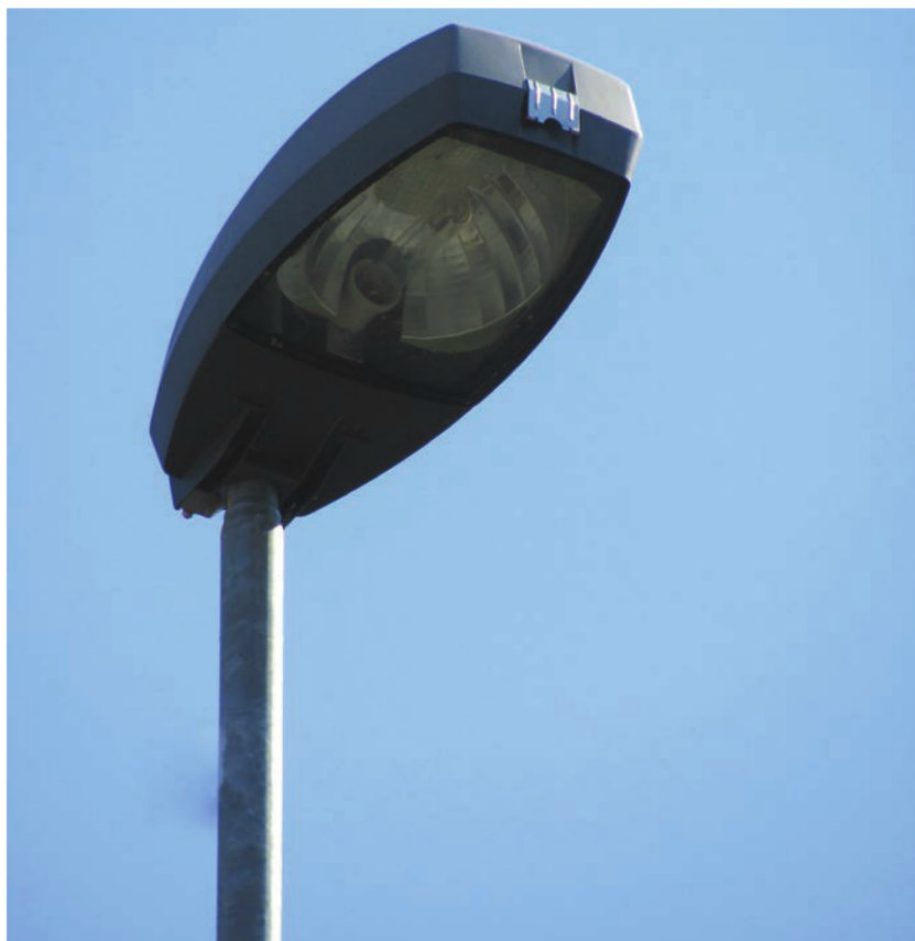
Vse novo vgrajene svetilke omogočajo zmanjšanje svetlobnega toka v nočnem času za 50 odstotkov.
